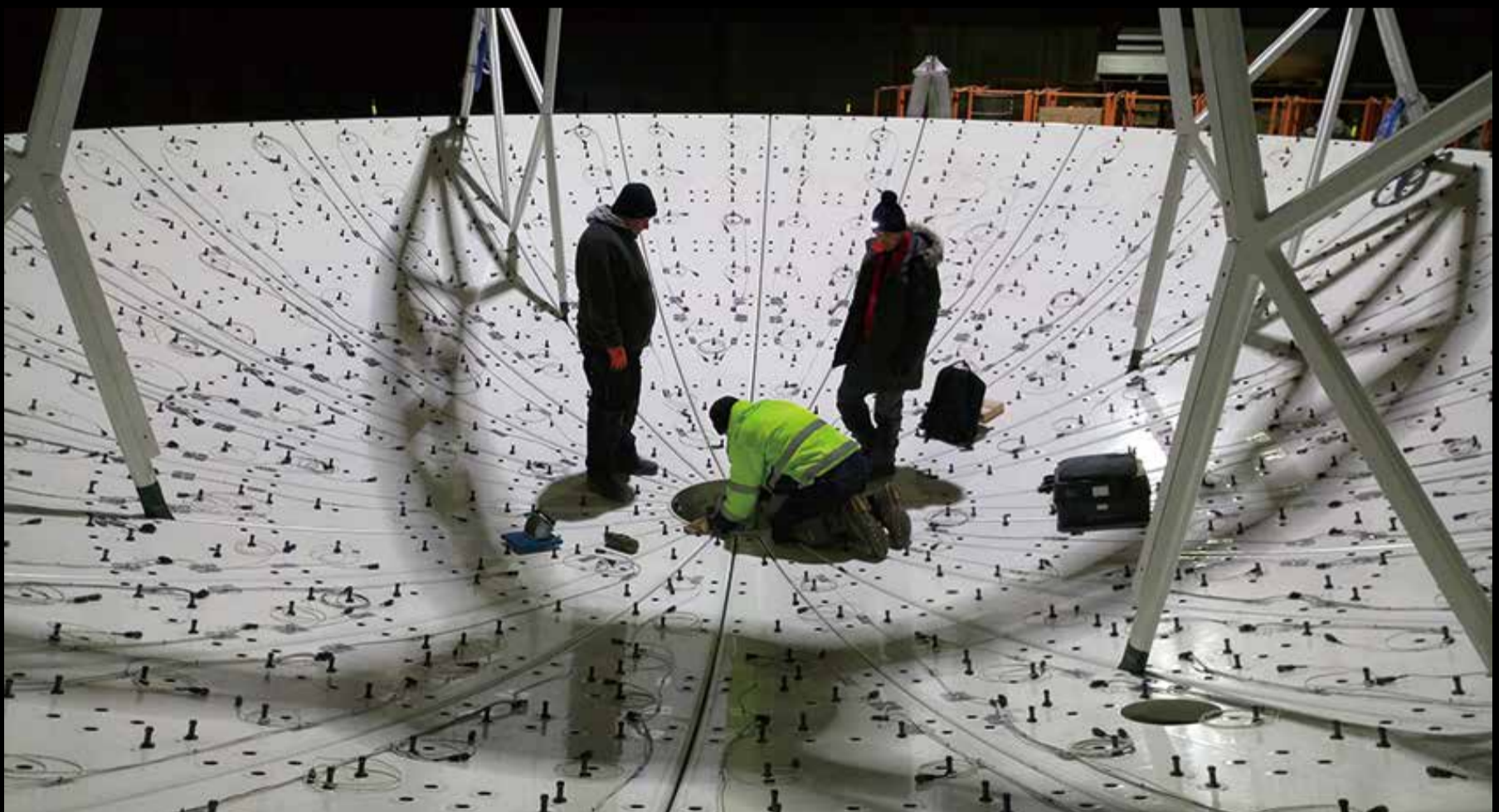
工程人員正在天線碟面上安裝除冰系統控制線。 © 中研院天文所
